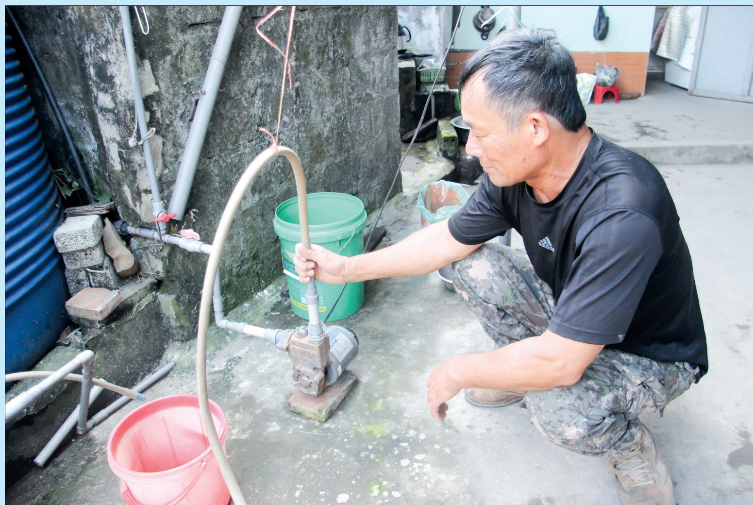
Người dân thôn Phương Trạch Đông, xã Phương Công (Tiên Hải) phải sử dụng bơm để lấy nước giếng khoan sử dụng trong sinh hoạt.
