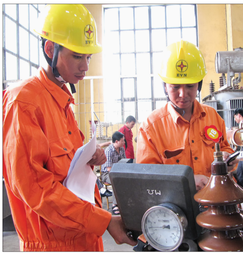
Công nhân Công ty Điện lực Thái Bình kiểm tra bảo dưỡng trạm biến áp.
