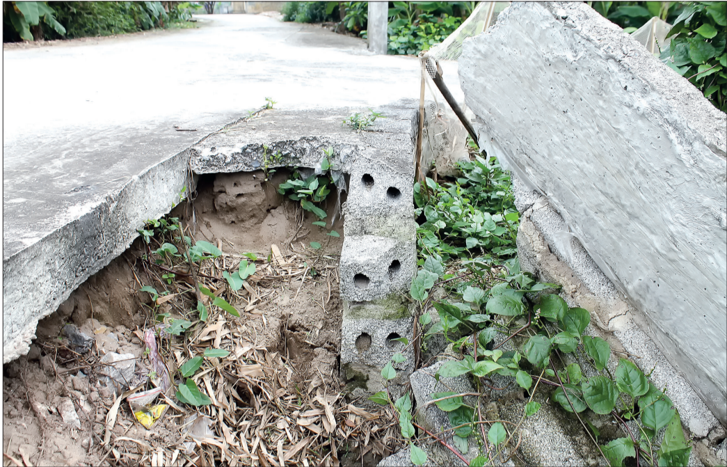
Lề đường trên đoạn đường trục thôn Nam Long bị sạt lở.
