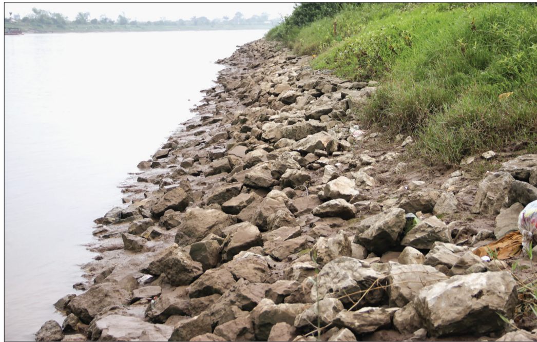
Kê Đống Phú hiện đã bị sạt lở và tụt mất đá nhưng chưa được xử lý.
