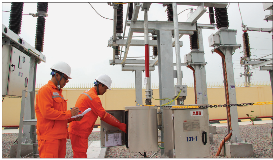
Công nhân ngành điện kiểm tra thông số hoạt động của trạm biến áp 110KV.
