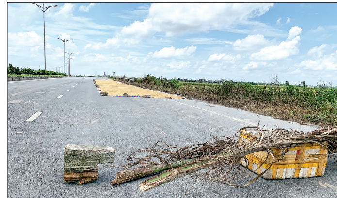
Tuyến đường tránh phía Nam thành phố, đoạn qua địa phận xã Vũ Lạc, xã Vũ Chính (thành phố Thái Bình) cũng là "điểm nóng" nhiều năm nay về tình trạng phơi thóc trên đường giao thông.
