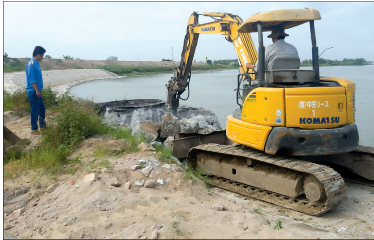
Lực lượng chức năng phá dỡ công trình xây dựng vi phạm gây cản trở hành lang thoát lũ trên bãi sông triển đê Trà Lý thuộc địa phận huyện Đông Hưng.
