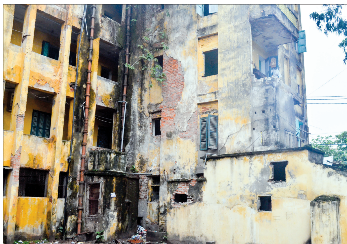
Khu tập thể 4 - 5 tầng phường Lê Hồng Phong (thành phố Thái Bình) đã xuống cấp trầm trọng, đang có nguy cơ đổ sập, đe dọa tính mạng người dân và ảnh hưởng xấu đến mỹ quan đô thị.
