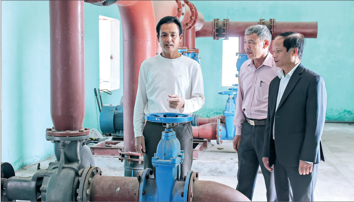
Hệ thống cung cấp nước sinh hoạt cho 6 xã: Thái An, Thái Học, Thái Tân, Thái Thuận, Thái Thành, Thái Thịnh (Thái Thụy).
