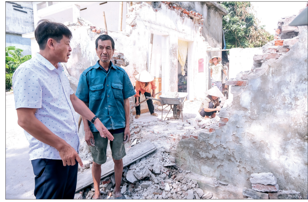
Gia đình ông Đỗ Văn Cường, thôn Chí Cường, xã Nam Cường (Tiến Hải) tháo dỡ nhà cũ để xây dựng nhà đại đoàn kết.
