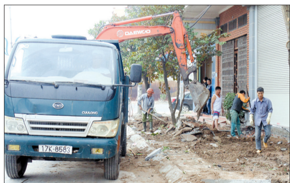
Cải tạo vỉa hè đường Long Hưng (phường Hoàng Diệu, thành phố Thái Bình).
