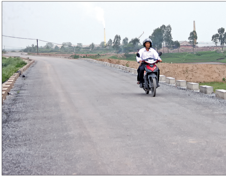
Hơn 5,5km đê hữu Trà Lý đoạn qua địa phận hai huyện Kiến Xương, Tiến Hải đã hoàn thiện, đáp ứng công tác phòng, chống thiên tai và tìm kiếm cứu nạn.
