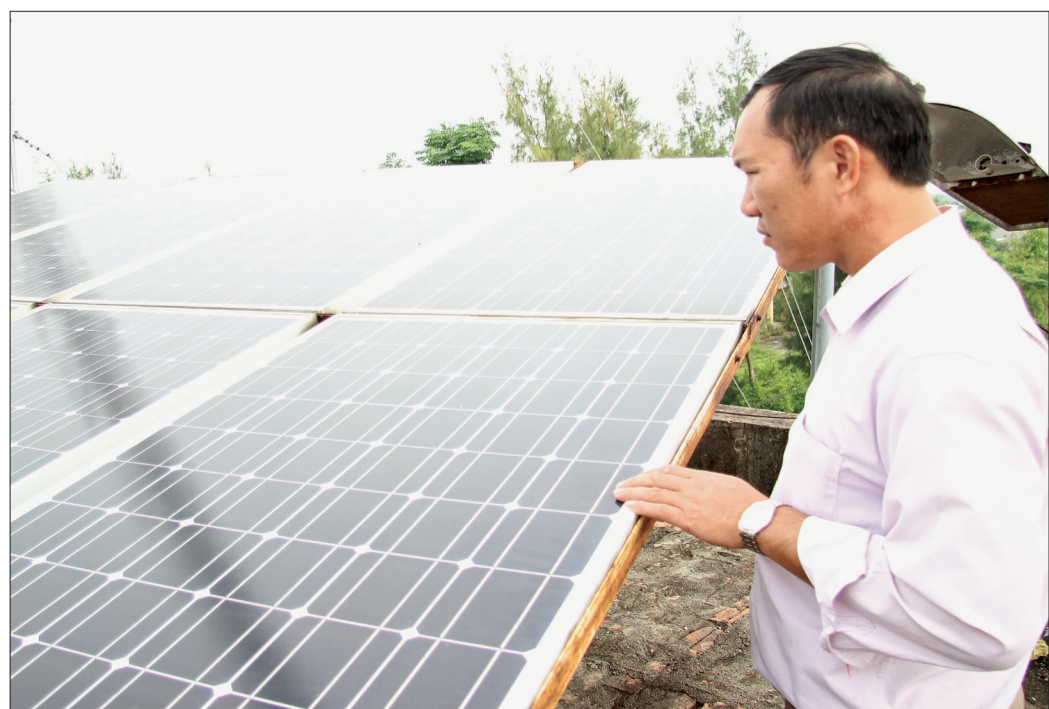
Hệ thống điện năng lượng mặt trời lắp đặt tại trụ sở UBND xã Nam Cường (Tiền Hải).
