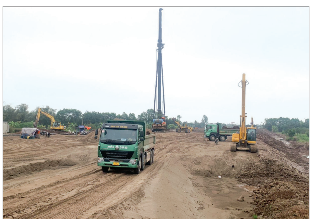
Thi công tuyến đường trục số 3 kết nối các khu chức năng trong Khu kinh tế Thái Bình đoạn qua địa bàn xã Nam Hải.
