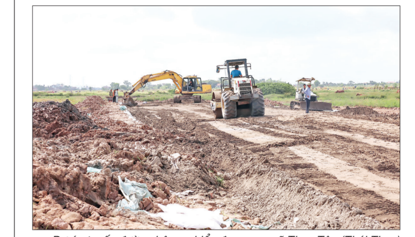
Dự án tuyến đường bộ ven biển đoạn qua xã Thụy Tân (Thái Thụy) đang tiến hành thi công.
