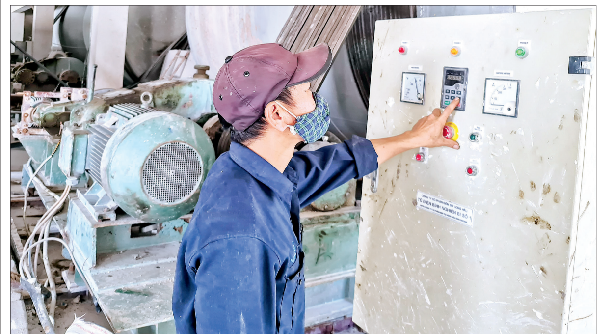
Công ty Cổ phần Gốm sứ Long Hâu (khu công nghiệp Tiên Hải) sử dụng thiết bị biến tần cho động cơ điện công suất lớn để tiết kiệm điện.
