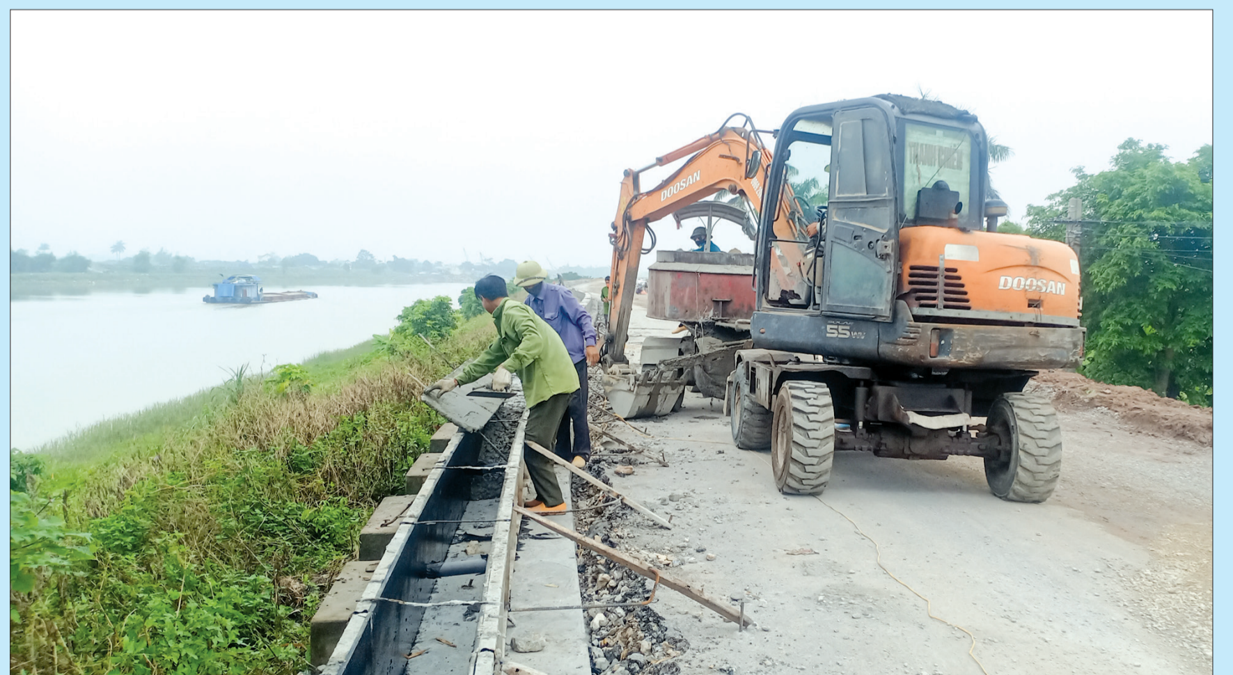
Công nhân Công ty TNHH Môi trường xanh Long Hưng đẩy nhanh tiến độ thi công đê tả Trà Lý.
