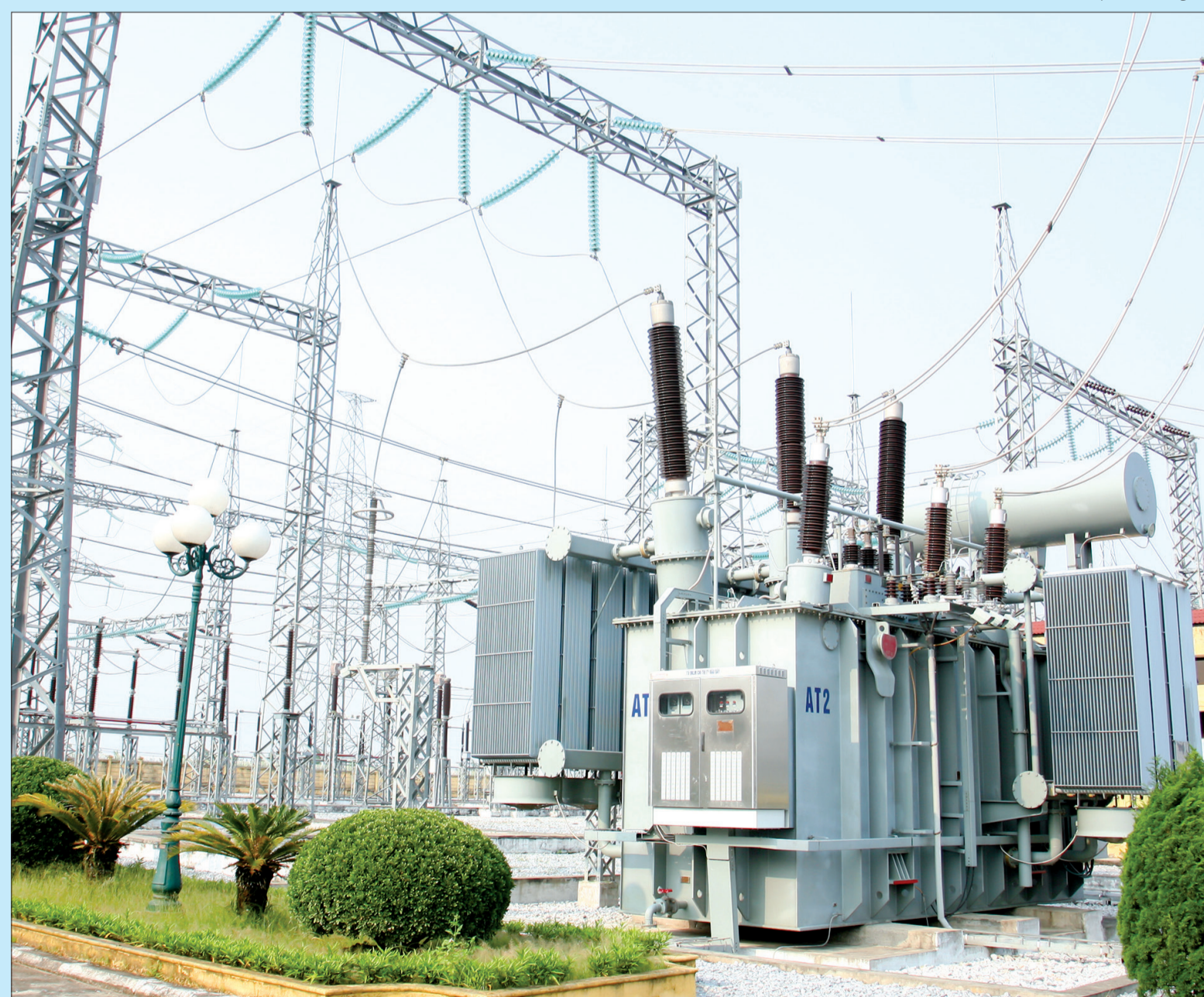
Các công trình điện được đầu tư xây dựng đáp ứng nhu cầu phát triển kinh tế - xã hội.
