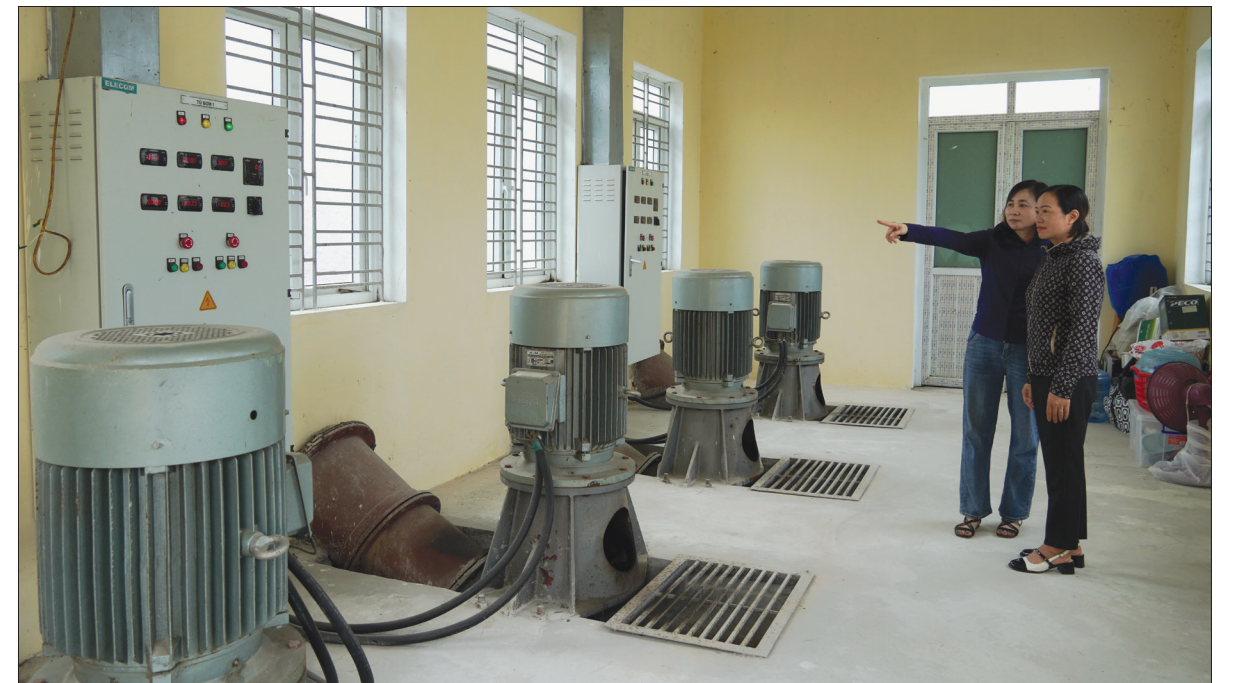
Trạm bơm Khai Lai gồm 4 máy công suất 2.500m 3 /h phục vụ công tác phòng, chống thiên tai.
