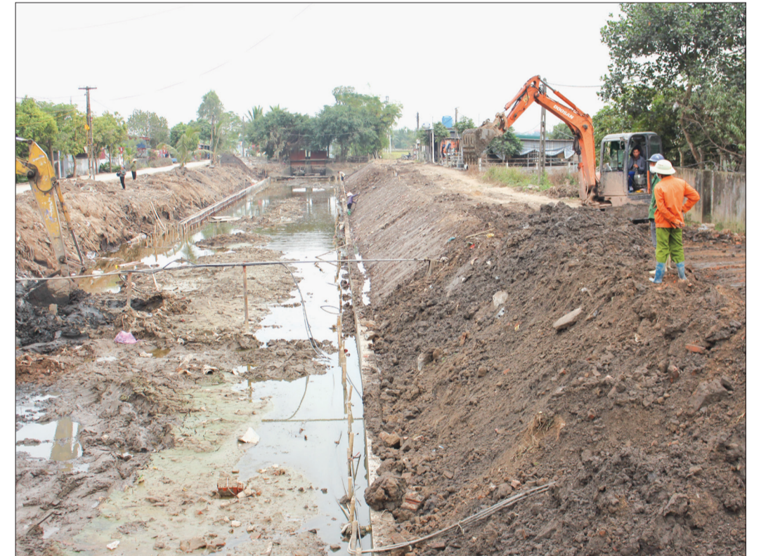
Thi công dự án xử lý nạo vét và gia cố mái bờ sông N2, huyện Thái Thụy.
