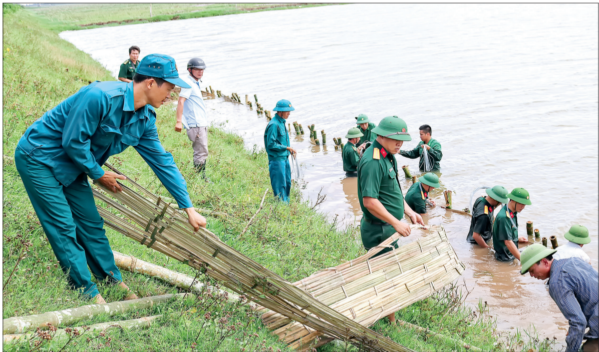
Lực lượng vũ trang huyện Tiên Hải tham gia khắc phục sự cố sạt lở tuyến đê số 5 qua địa phận xã Nam Phú.
