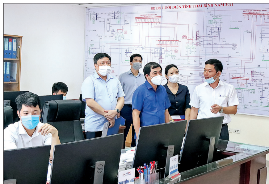
Đổng chí Nguyễn Tiến Thành, Phó Bí thư thường trực Tỉnh ủy, Chủ tịch HĐND tỉnh kiểm tra tại trung tâm điều khiển xa của Công ty Điện lực Thái Bình.
