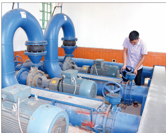
Công nhân nhà máy nước sạch Nam Chính vận hành hệ thống bơm áp lực.
