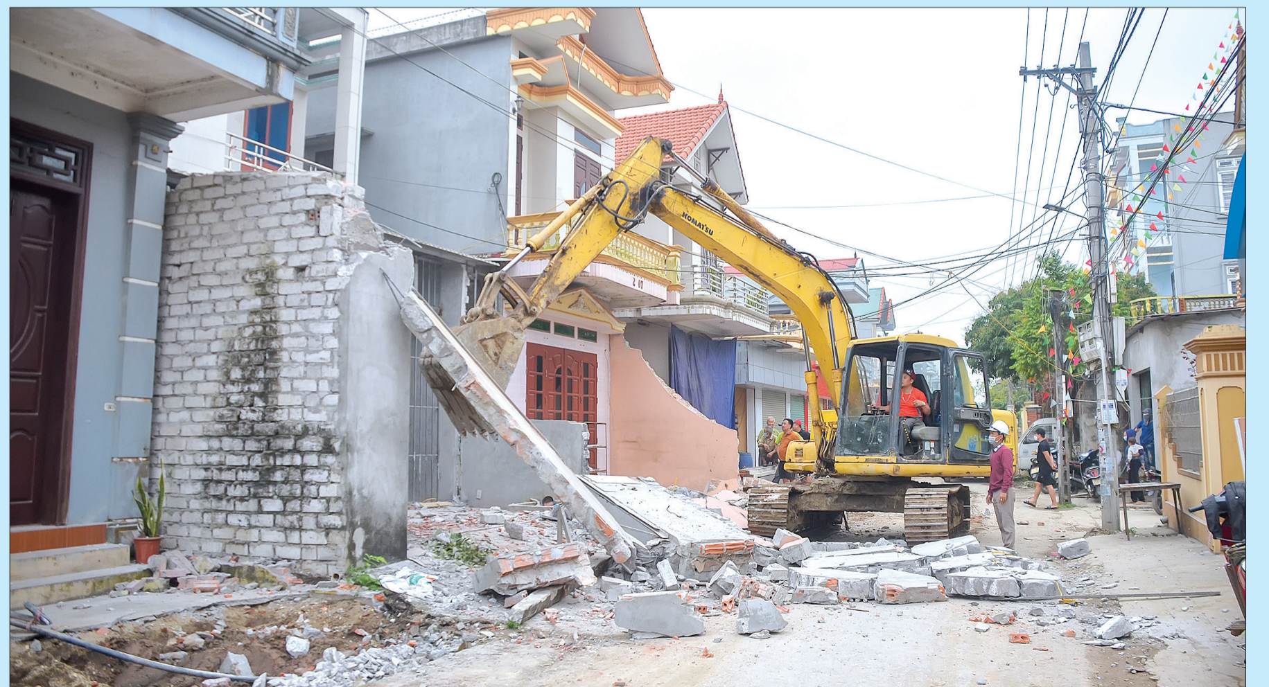
Những hộ dân xã An Thanh (Quỳnh Phụ) tự nguyện hiến đất và tài sản trên đất để cải tạo, nâng cấp, mở rộng đường.
