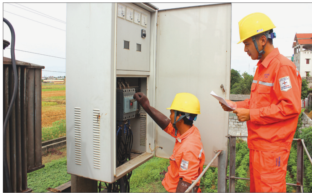
Công nhân Công ty Điện lực Thái Bình kiểm tra máy biến áp bảo đảm cấp điện ổn định, an toàn trong những ngày nắng nóng.
