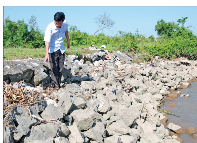
Hệ thống mô kè bãi sông khu vực xã Vũ Bình (Kiến Xương) đang xuống cấp nghiêm trọng.
