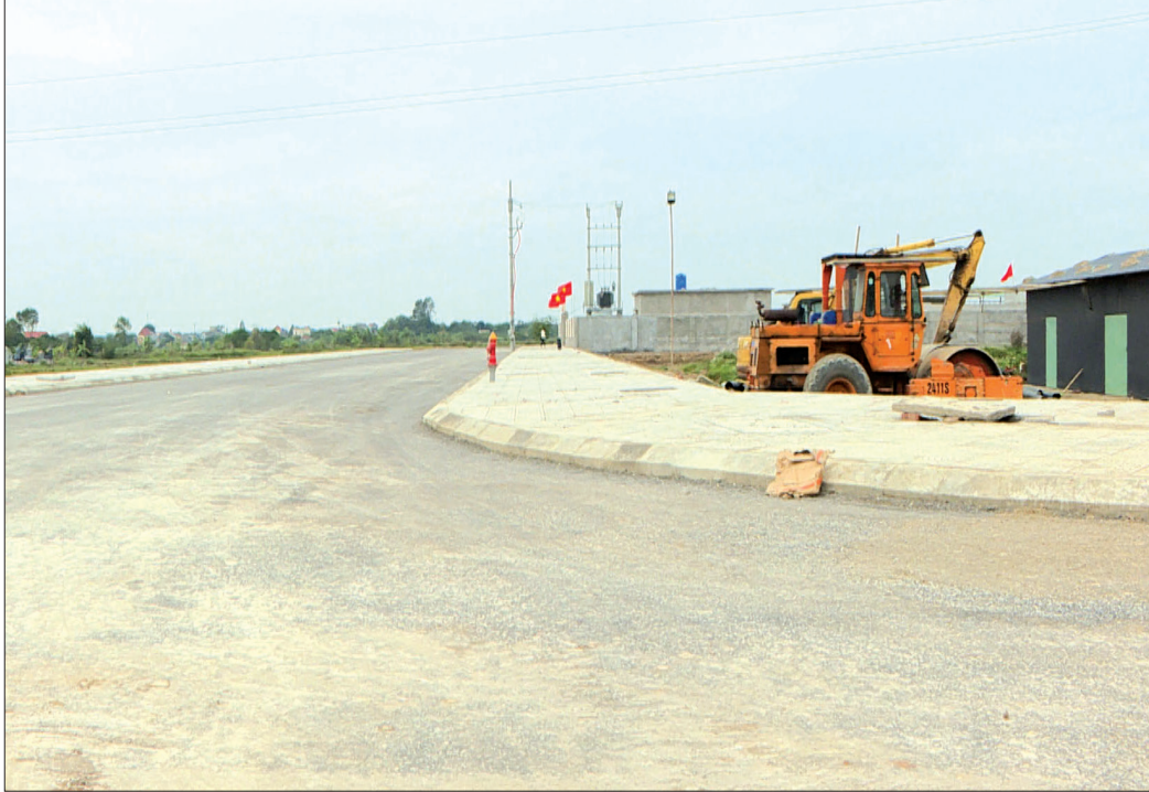
Cụm công nghiệp Thống Nhất từng bước hoàn thiện sẵn sàng thu hút các nhà đầu tư thứ cấp.
