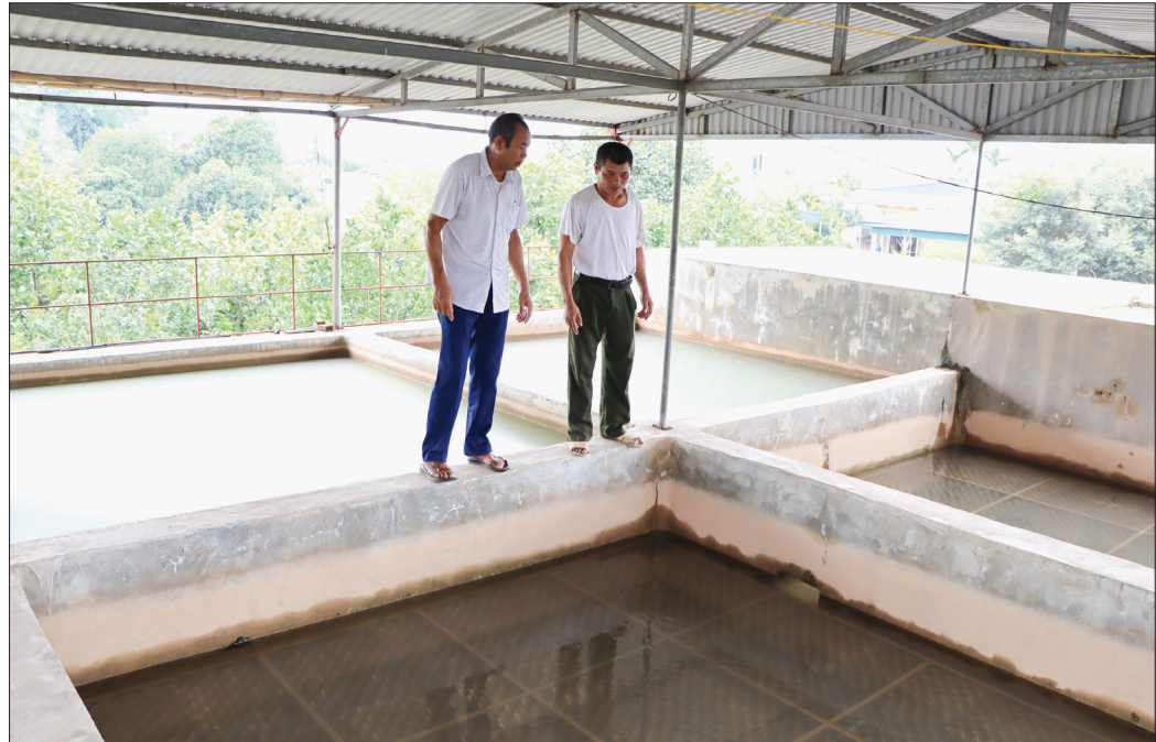
Nhà máy nước xã Lê Lợi hiện đang cung cấp nước ổn định cho hơn 9.000 hộ dân trên địa bàn 4 xã.
