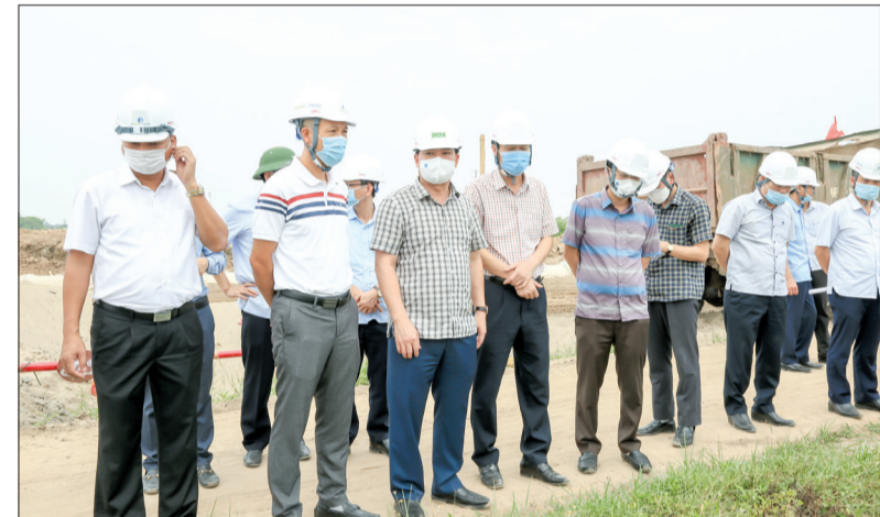
Đồng chí Nguyễn Khắc Thân, Phó Bí thư Tỉnh ủy, Chủ tịch UBND tỉnh kiểm tra công tác giải phóng mặt bằng và thi công dự án khu công nghiệp Liên Hà Thái.
