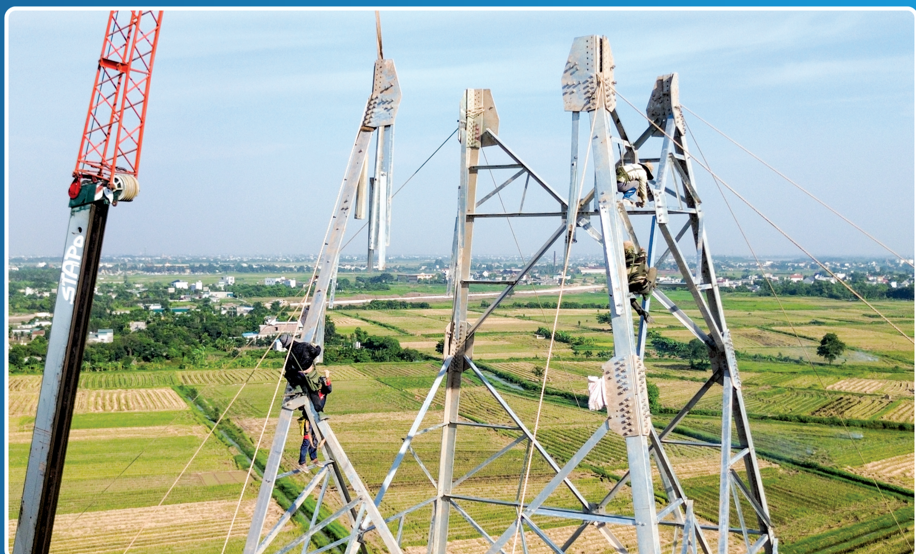
Đẩy nhanh tiến độ lắp dựng cột điện đường dây 500kV mạch 3 trong điều kiện nắng nóng.
