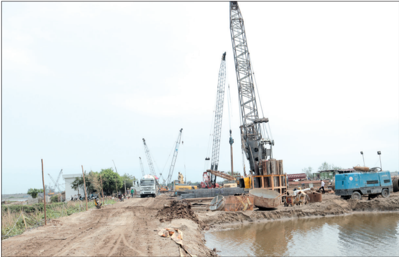
Thi công cầu vượt sông Trà Lý nối hai huyện Thái Thụy - Tiến Hải trong dự án tuyến đường bờ ven biển đoạn qua địa phận tỉnh Thái Bình.
