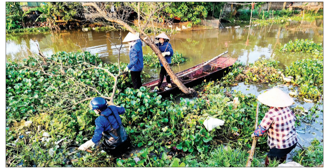
Xí nghiệp Khai thác công trình thủy lợi huyện Hưng Hà huy động nhân viên giải phóng dòng chảy.
