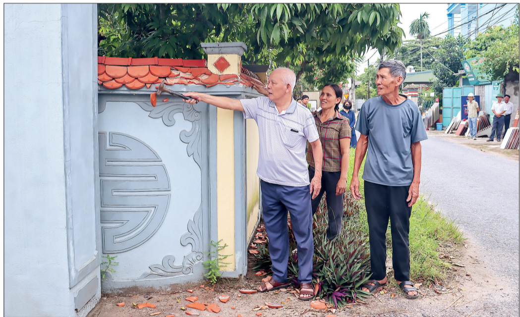
Nhờ thực hiện tốt công tác tuyên truyền, vận động, các hộ dân trên địa bàn xã Bình Định (Kiến Xương) đều đồng thuận với chủ trương hiến đất, phá dỡ tường bao, bàn giao mặt bằng cho đơn vị thi công.
