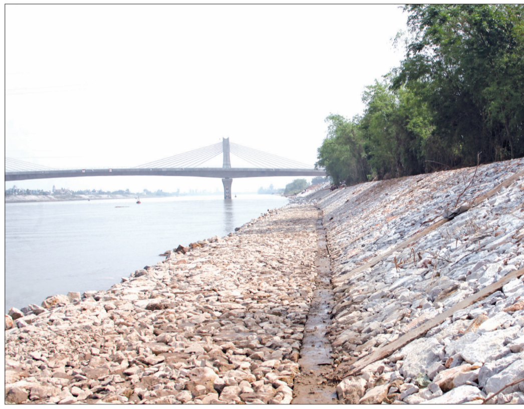
Kè Vu Đông, đoạn qua địa phận xã Vu Đông (thành phố Thái Bình) đã cơ bản hoàn thiện.
