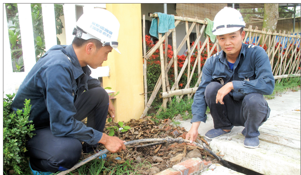
Nhân viên Công ty TNHH Thương mại Đồ Gia Bảo kiểm tra, phát hiện người dân đấu nối đường ống nước đồng hồ do nước để trạm cấp nước sạch.
