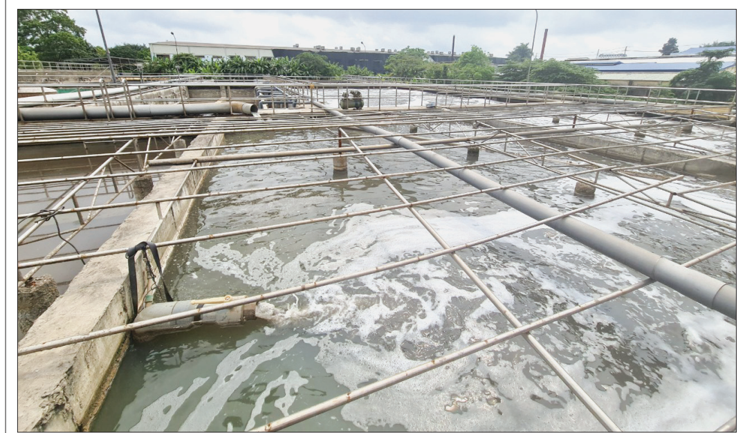
Trạm xử lý nước thải khu công nghiệp Nguyễn Đức Cảnh vận hành 24/24 giờ.
