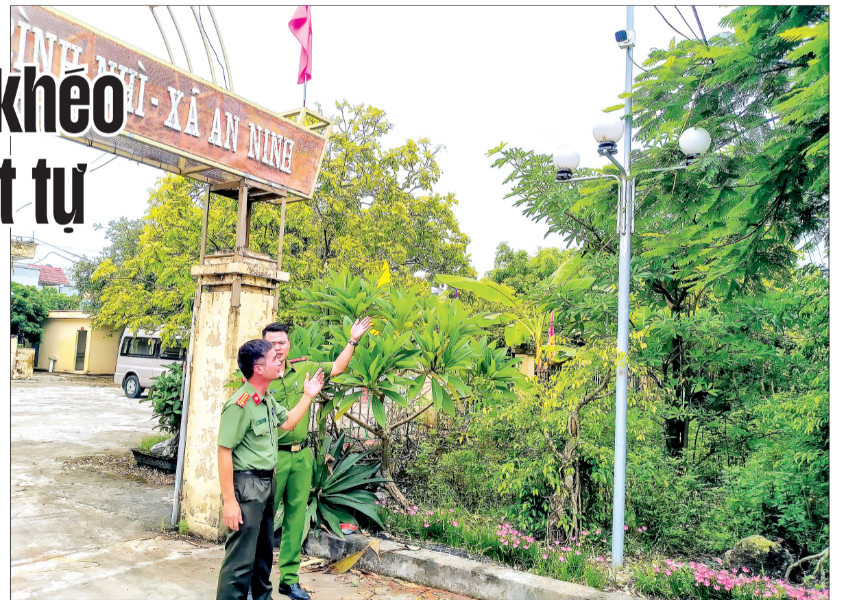
Camera an ninh được lắp đặt tại các tuyến đường, nút giao thông quan trọng, khu vực công cộng, tập trung đông dân cư trên địa bàn xã.
