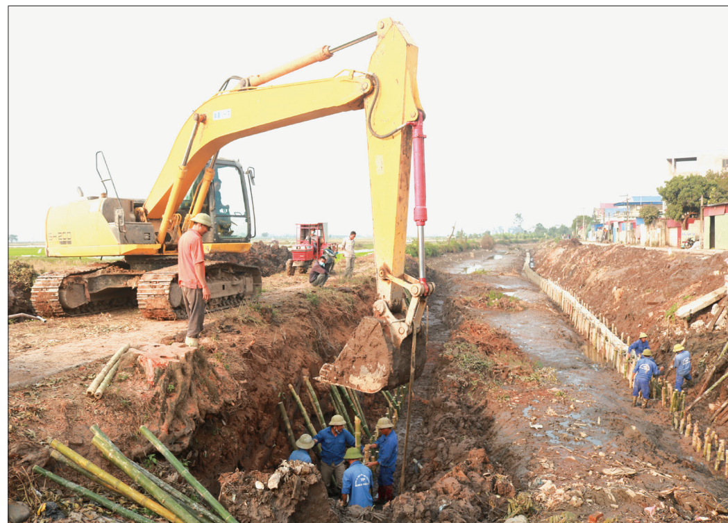
Thi công hạng mục kê lát mái taluy đoạn từ ĐT.453 đến quốc lộ 39 thuộc dự án đầu tư xây dựng tuyến đường từ thành phố Thái Bình qua cầu Tịnh Xuyên đến huyện Hưng Hà.
