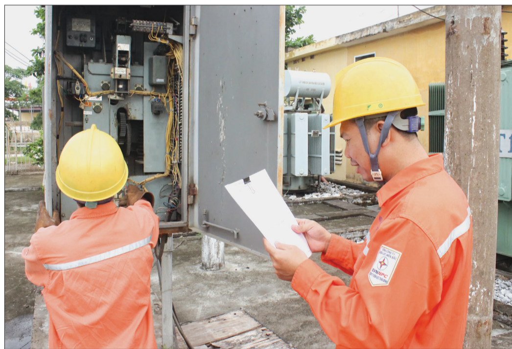
Công nhân Công ty Điện lực Thái Bình kiểm tra hệ thống máy biến áp bảo đảm cung cấp điện ổn định, an toàn.
