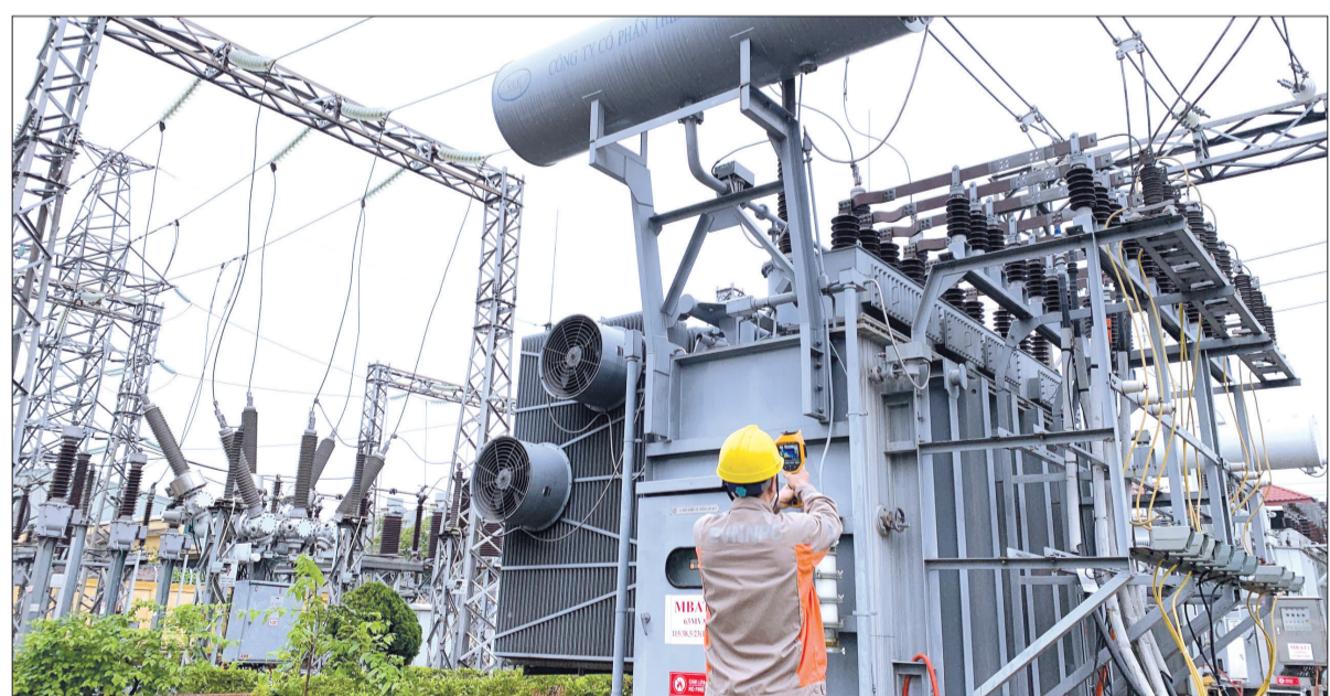
Điện lực Tiên Hải thường xuyên kiểm tra, bảo dưỡng trạm biến áp 110kV Tiên Hải nhằm bảo đảm cung cấp điện ổn định, an toàn.
