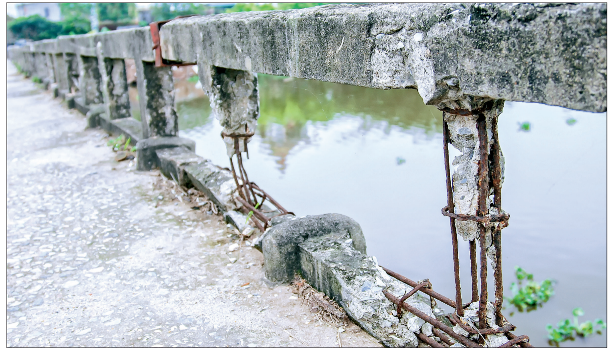
Đã được xử lý tạm thời nhưng cây cầu này vẫn không bảo đảm an toàn cho người dân đi qua đây.
