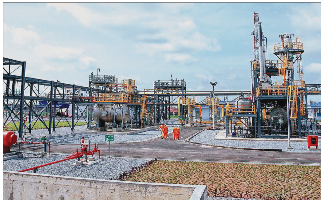
Hệ thống phân phối khí thấp áp tại khu công nghiệp Tiên Hải.
