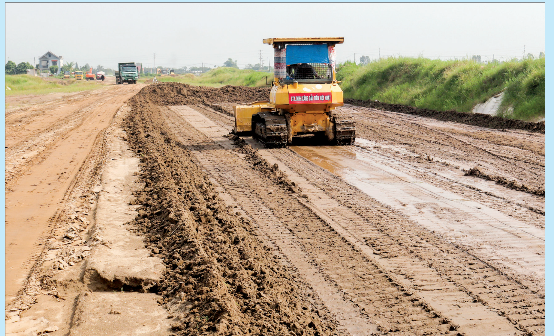
Thi công tuyến đường từ thành phố Thái Bình đi cầu Nghìn đoạn qua xã Đông Sơn (Đông Hưng).
