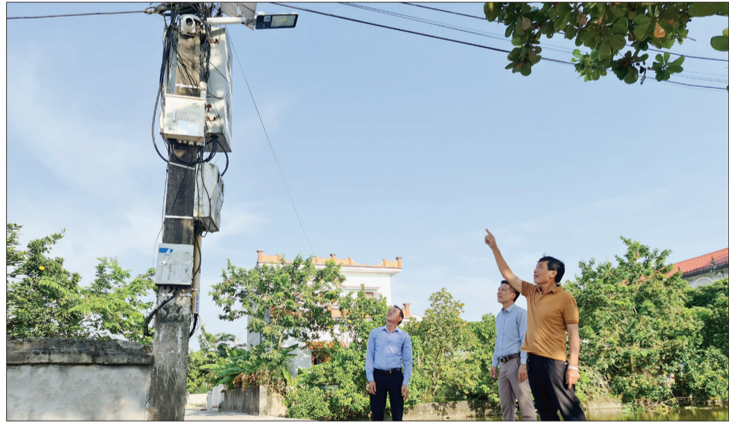
Hệ thống đèn năng lượng mặt trời mới lắp đặt trên đường trục thôn Đào Xá Cán Phán, xã Quỳnh Hoàng.
