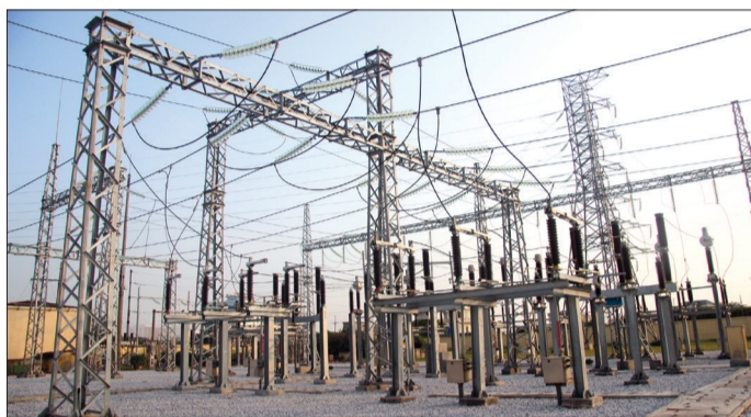
Hệ thống điện tại huyện Tiền Hải được đầu tư đồng bộ, cung cấp điện ổn định cho các khu, cụm công nghiệp.
