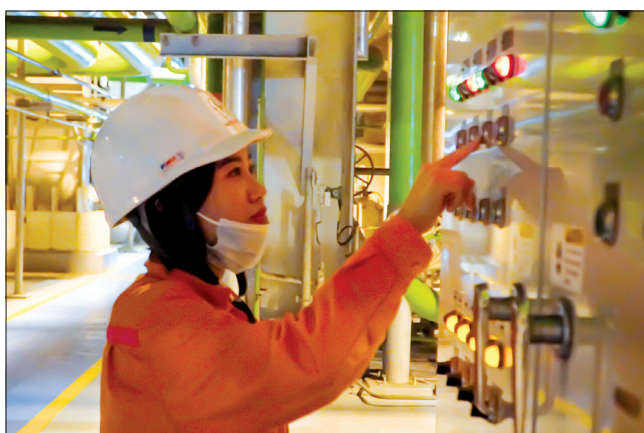
Chị Vũ Thị Vân, máy phó phân xưởng vận hành cho biết: Việc thường xuyên giám sát, kiểm tra, hiệu chỉnh thiết bị sẽ giúp cho hệ thống máy móc của nhà máy hoạt động tin cậy, an toàn, hạn chế tối đa xảy ra hỏng hóc, sự cố.
