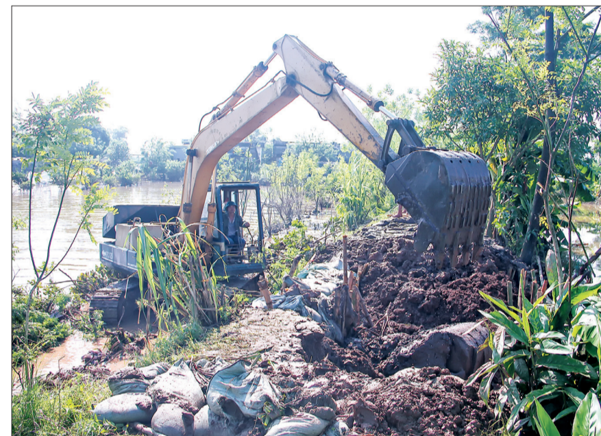
Lực lượng chức năng xử lý sự cố tràn bờ bao tại xã Vũ Hòa (Kiến Xương).
