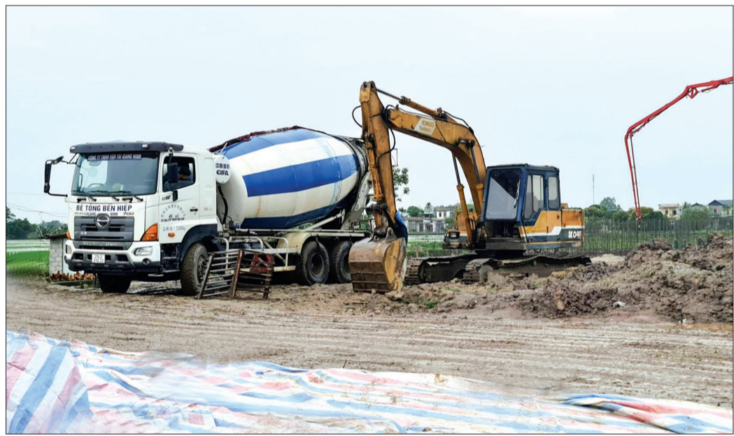
Nhà đầu tư hạ tầng huy động máy móc, nhân lực thi công hạ tầng kỹ thuật cụm công nghiệp Quỳnh Giao.
