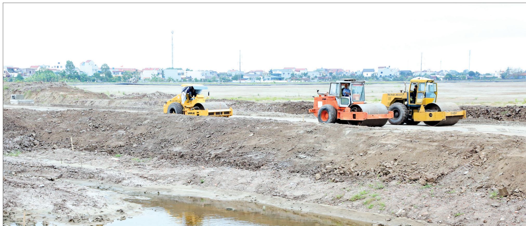
Thi công hạ tầng kỹ thuật khu công nghiệp Liên Hà Thái.
