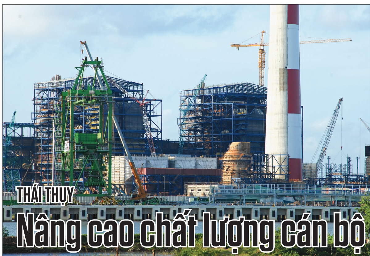
Nhà máy nhiệt điện Thái Bình 1 (xã Mỹ Lộc, huyện Thái Thụy).
