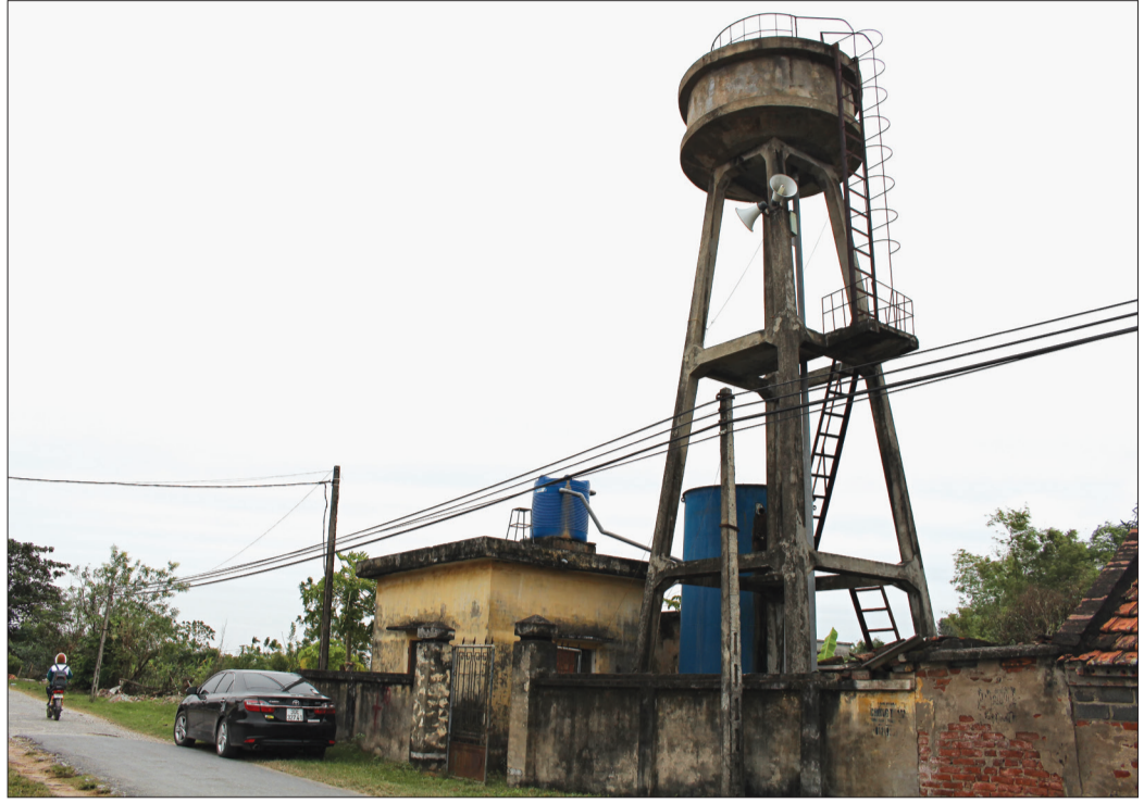
Trạm cấp nước sạch thôn Hưng Đạo, xã Vũ Lăng (Tiền Hải).
